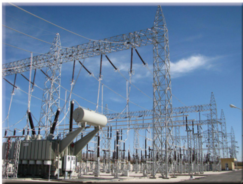
احداث پست ۶۳/۴۰۰ کیلوولت DCS سعادت شهر کارفرما: شرکت برق منطقه ای فارس مشاور: شرکت مشانیر
