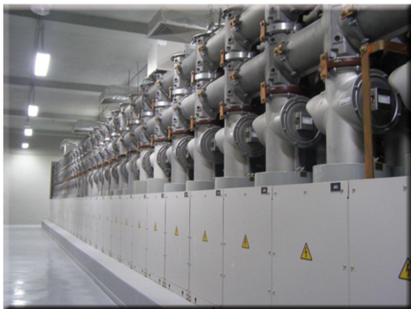
احداث دو دستگاه پست ۲۰/۱۳۲ کیلوولت GIS کارفرما: شرکت پتروشیمی مبین مشاور: شرکت مונنگو
